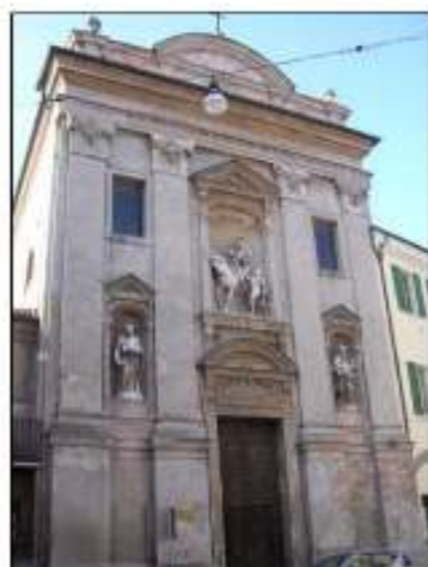
Chiesa di S. Martino, studio sistematico degli studenti del corso di restauro della Facoltà di Architettura
