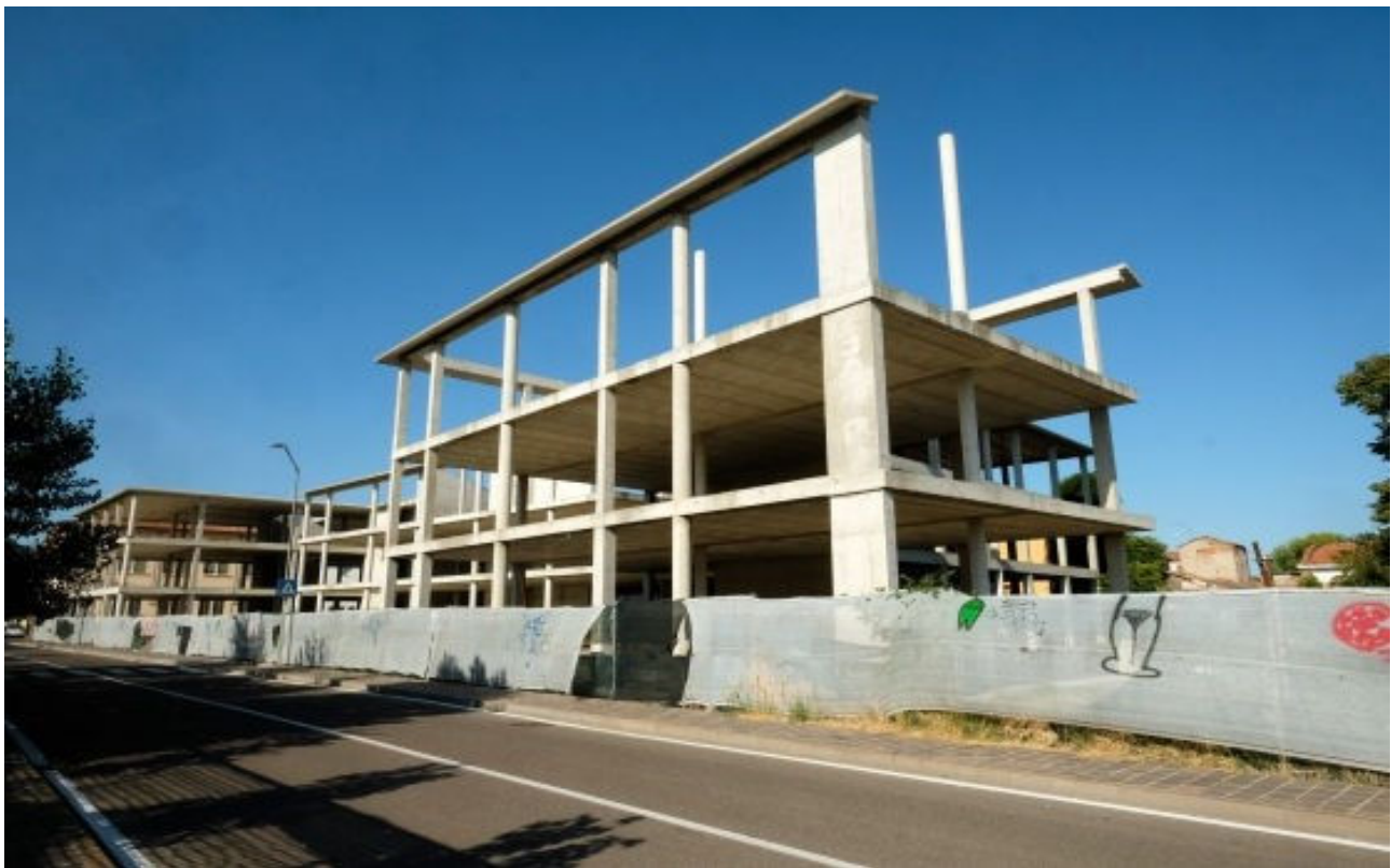
Immobile del quartiere, esemplificativo dello stato di degrado del comparto
