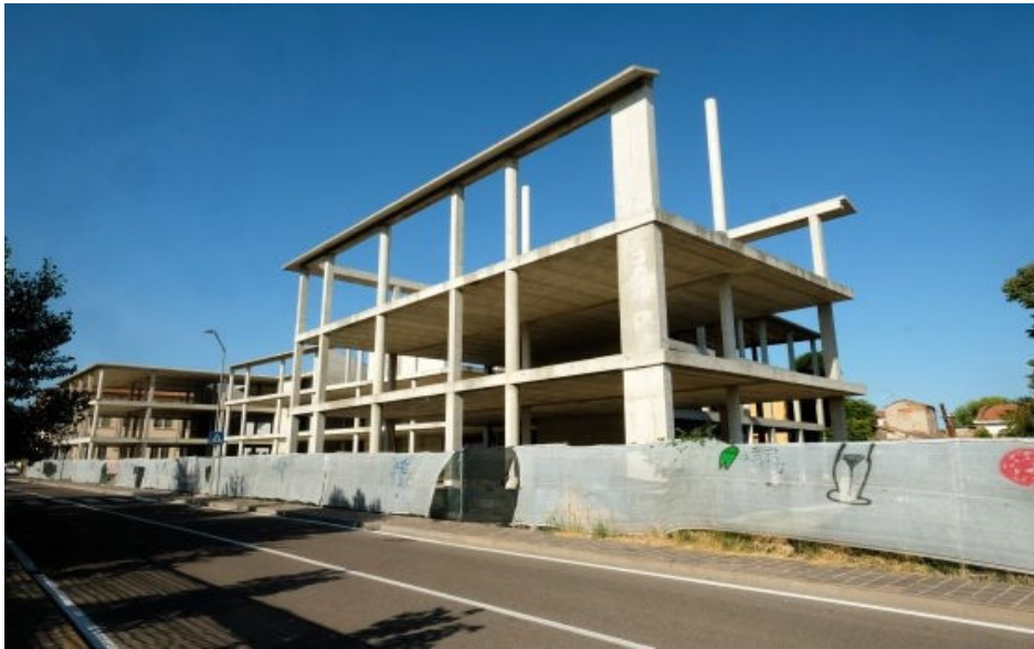
Fig. 13 – Ex Comparto C2 immobile parziale rete realizzato e mai terminato
